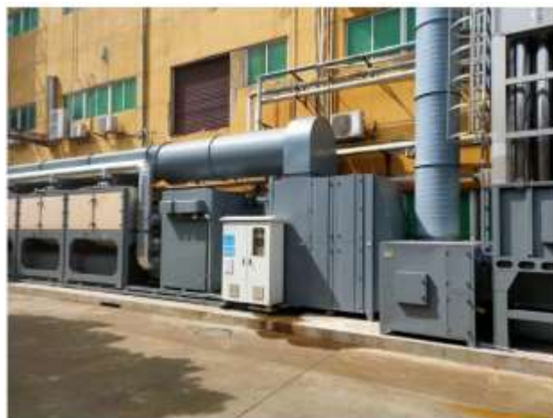
活性碳吸附濃縮及催化燃燒組合裝置
