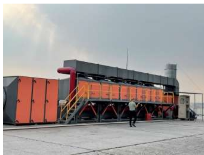
活性炭吸附濃縮及催化燃燒設備-手噴漆
