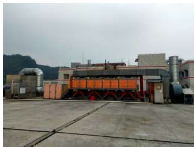
活性炭吸附濃縮及催化燃燒設備-靜電噴塗
