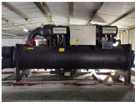
磁懸浮冷水機主機正面
