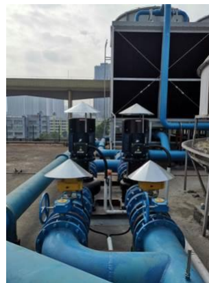
磁懸浮冷水機系統冷卻水系統
