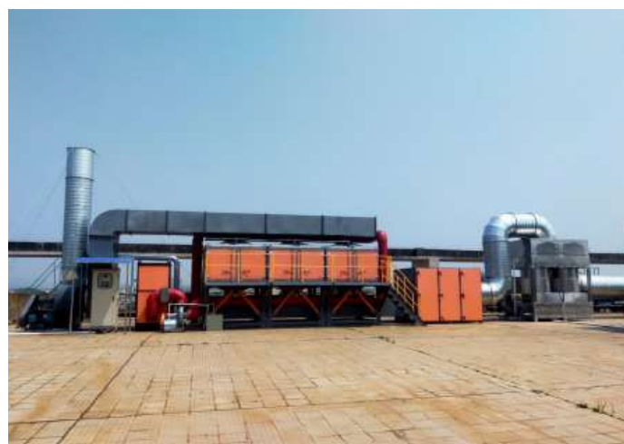
活性炭吸附濃縮及催化燃燒設備-靜電噴塗
