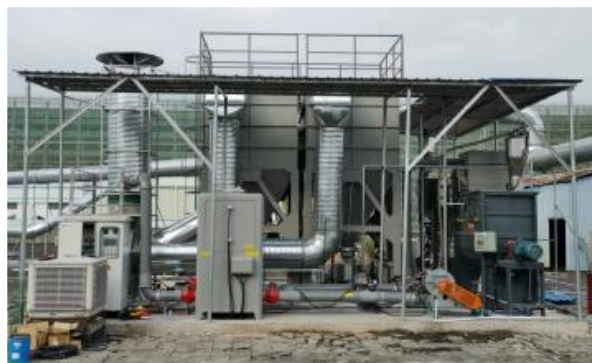
沸石吸附濃縮、自動脫附及催化分解設備
