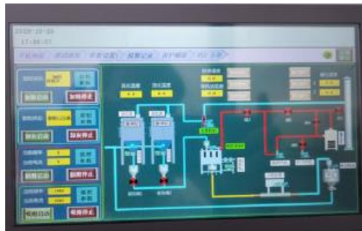
設備操作介面
