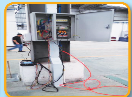
電力現場實測情況
