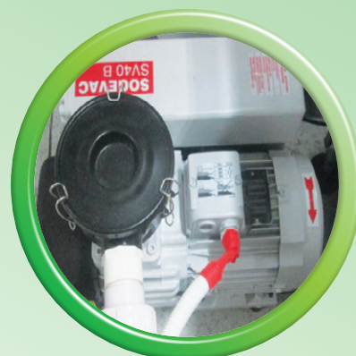
電真空泵區域真空系統
