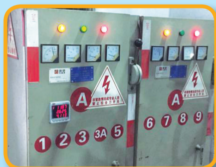
電錶現場安裝照片
