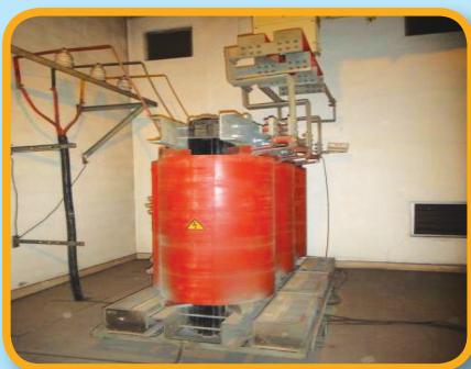
舊式SCB8變壓器
