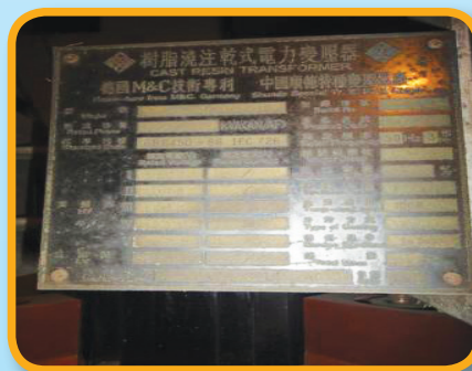
SCB8變壓器銘牌
