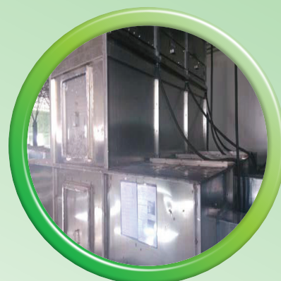
原來的噴水噴淋設備
