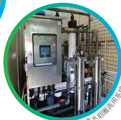
超磁分離安裝在沉澱槽內
