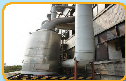
定型機煙霧淨化回收系統的外觀
