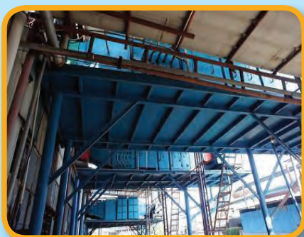
現場安裝的5套油煙淨化系統
