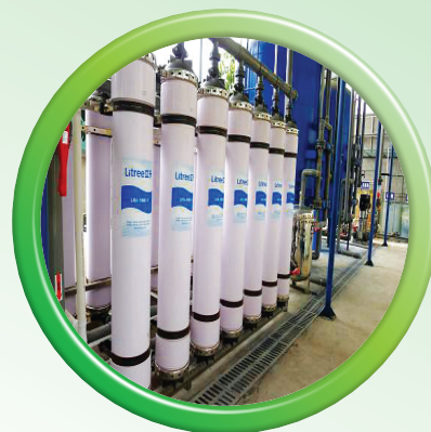
超濾膜過濾系統
