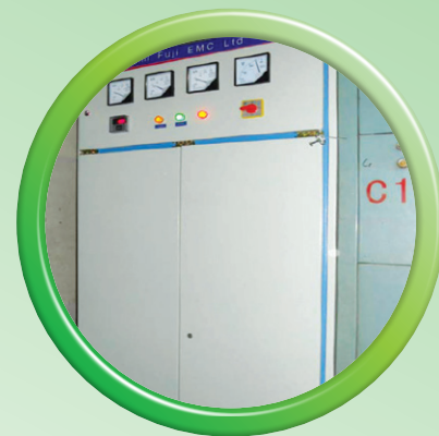
現場的省電機
