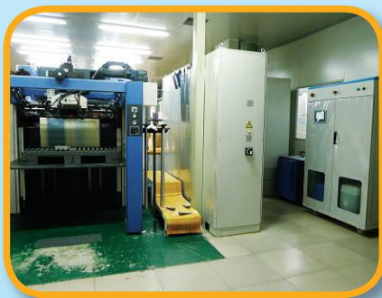
現場的水斗液循環過濾系統（右）
