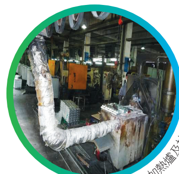
舊壓鑄機柴油保溫加熱爐及抽風設備
