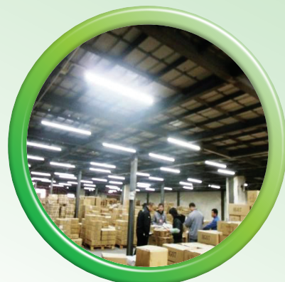
安裝在倉庫的LED燈
