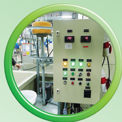
震動膜回收除蠟水系統
