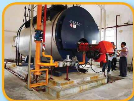
天然氣蒸汽鍋爐
