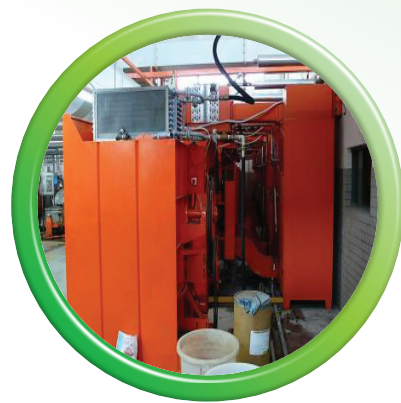
安裝在乾衣機背後的熱交換系統
