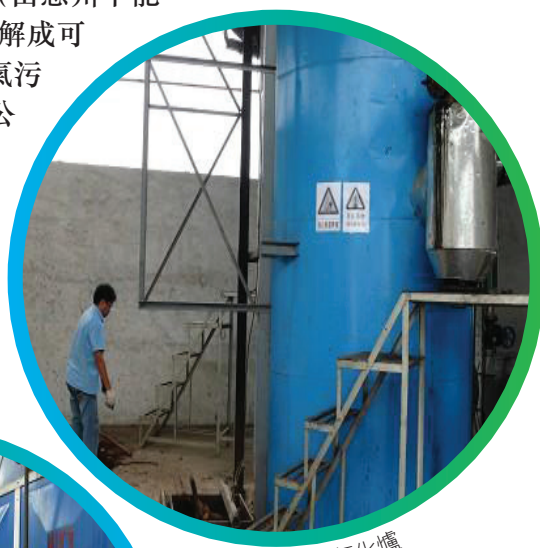
生物質氣化爐
