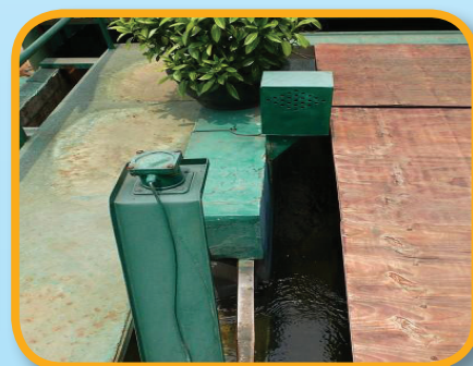
最終污水排放口
