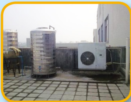
誘導蒸發冷氣+熱回收室外機和儲水罐
