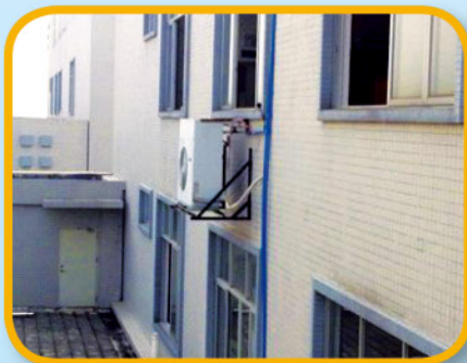
誘導蒸發冷氣機室外機
