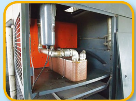
廢熱回收系統的熱交換器
