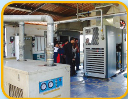
安裝了廢熱回收系統的空氣壓縮機
