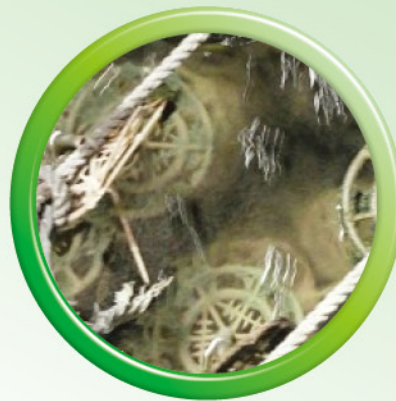
生化處理槽內填料
