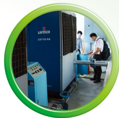
壓縮機熱水系統的控制面板
