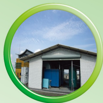
位於廠房天台的空氣壓縮機房
