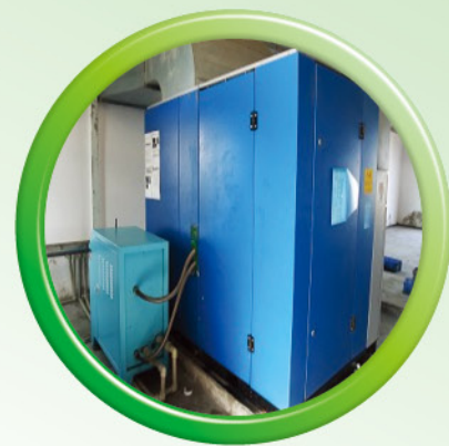
壓縮機熱水系統與空氣壓縮機
