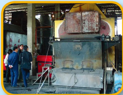
安裝在現場的鏈條鍋爐撥火助燃系統
