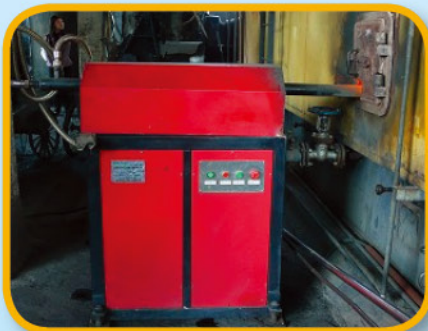
V-loop1鏈條鍋爐撥火助燃系統
