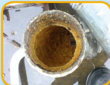
積垢嚴重的水管
