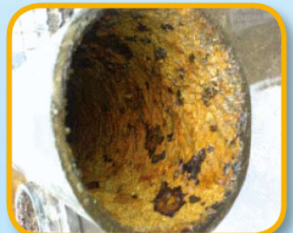
使用臭氧系統後改善了積垢厚度
