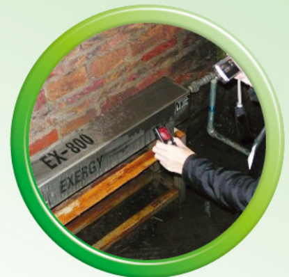
現場安裝的燃料節省裝置
