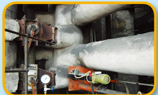
風送煤粉管的尾端安裝了鈍體燃燒器
