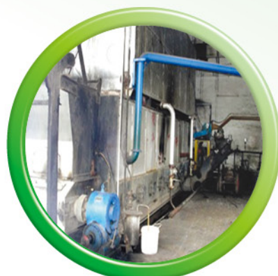
煤粉輸送管連接到鏈條鍋爐
