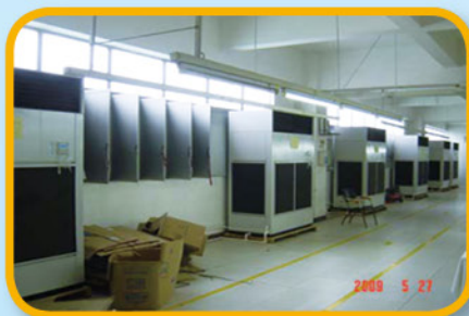
位於廠房內的誘導蒸發冷氣(室內機)
