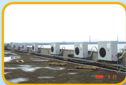
誘導蒸發冷氣位於室外的壓縮系統
