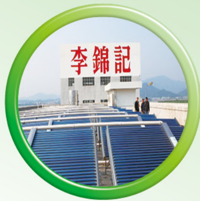
安裝於樓頂的太陽能集熱系統
