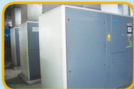
3台75kW的GA75型螺桿空壓機
