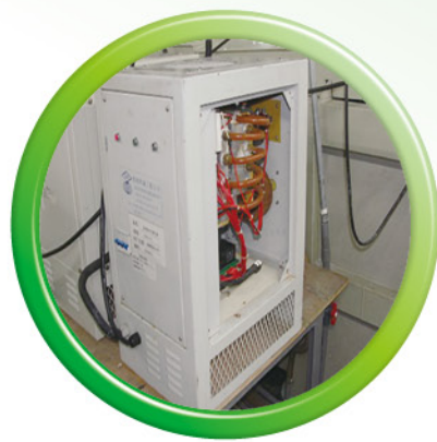
高頻開關電源機
