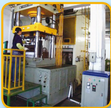
安裝了節電器的壓力機
