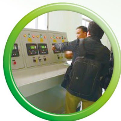
《電控系統》的外觀及面板操作裝置
