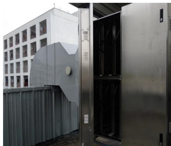
紫外線光解及活性炭吸附設備
