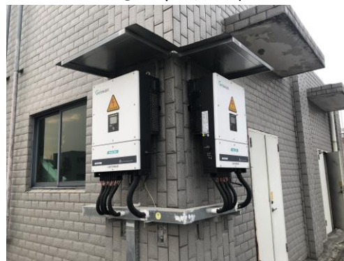
光伏系統逆變器
