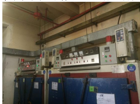
滴漆、烘乾車間廢氣收集裝置
