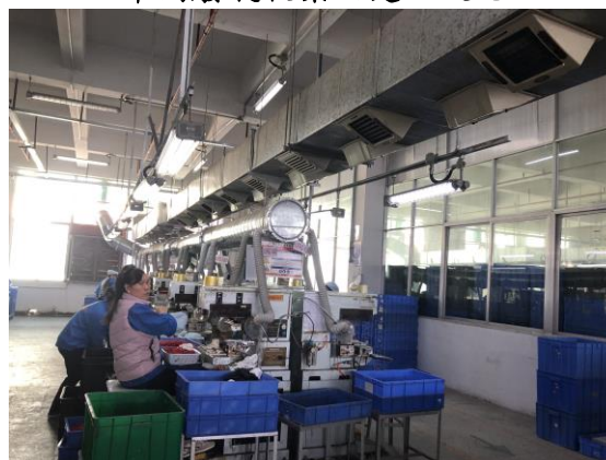
車間廢氣收集及處理設施
