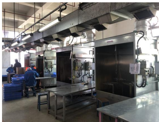
車間廢氣收集及處理設施
