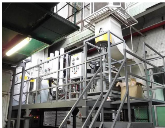
1#線上震動膜+RO 膜處理系統
