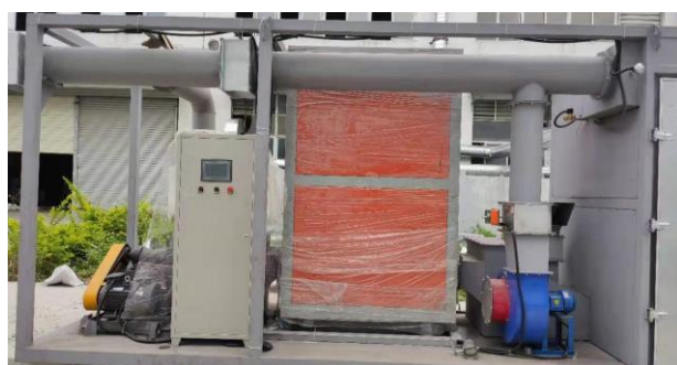
1#離線脫附燃燒設備
