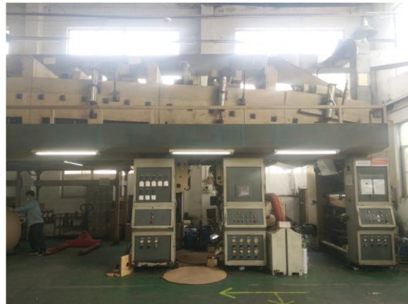
車間廢氣收集及處理設施
