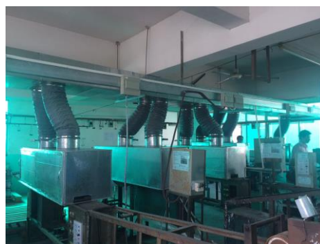
拼線車間收集管道
