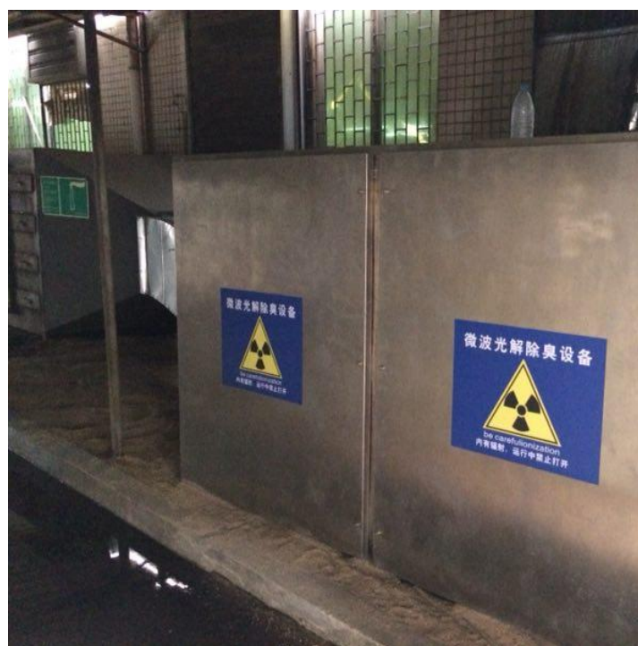
1#廢氣治理設施
