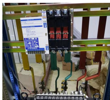
配自耦調壓器的能源節約系統
