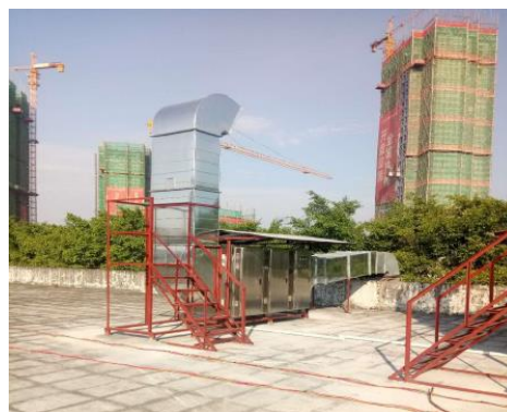
廢氣處理系統
