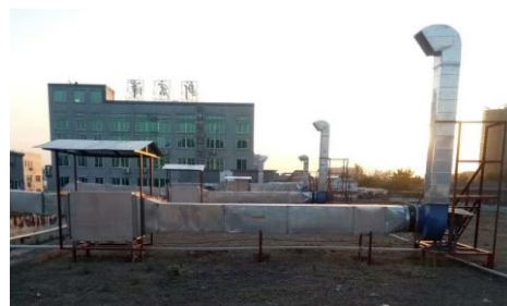
廢氣處理系統
