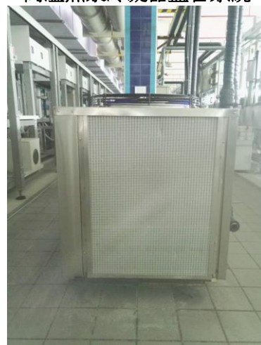
高溫熱泵冷凝器盤管系統
