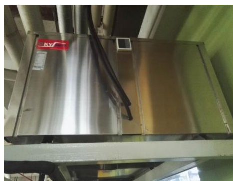
高溫熱泵冷凝器盤管系統
